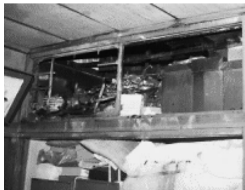
写真4 天袋の燃え下がり焼損状況
