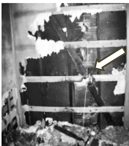
写真5 室内の壁間の残り火
