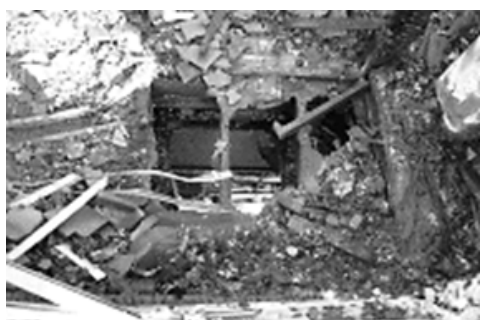
写真2 床抜けの現場調査
