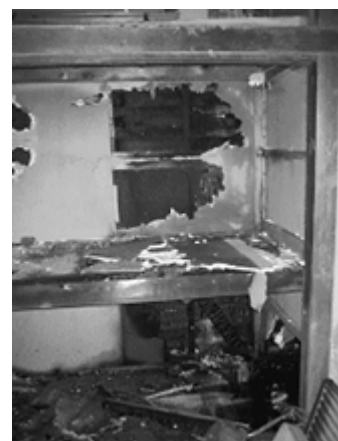
写真3 押入れの延焼経
