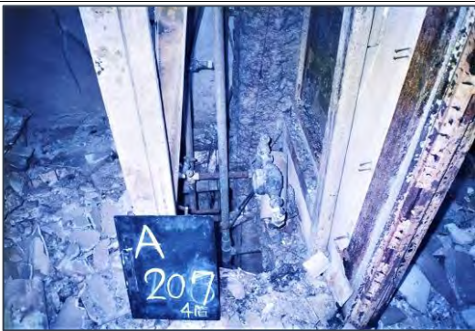
写真 6 耐火建物の下階からの延焼経路となったパイプスペース部分
