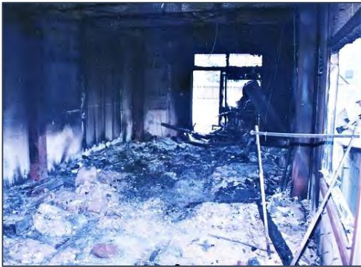
写真 5 耐火建物の 5 階の焼損状況
