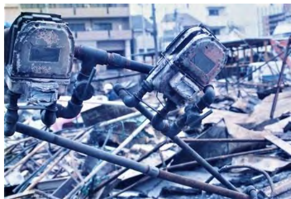
写真10 火災現場の2タイプのガスメータ。右がマイコン、左が旧タイプ。
