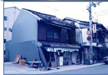
写真 追-2 木造建物 屋根瓦が落下、支柱がつぶれて倒壊危険が大
