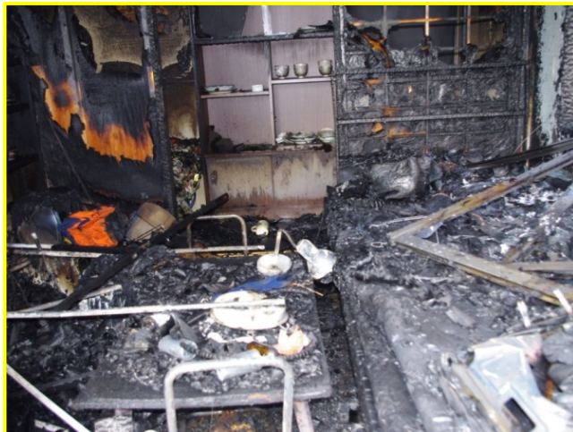
写真 k307-2 鎮火後の火災現場の焼損状況 これら、火災現場を見る眼を養うことが、火災鑑定の第一歩となる。
