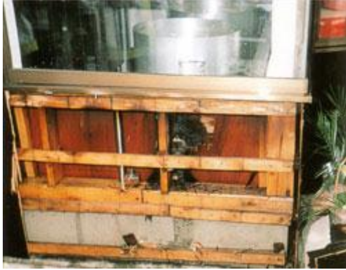
焼け焦げた側壁内部
