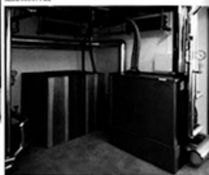
暖房と給湯のためのペレットボイラー
