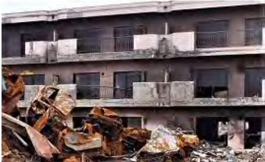
写真11 内部より外周部の焼損、特に2階床部が強い
