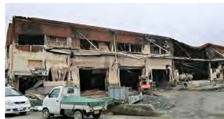
写真 5 建物東側(正面)からの焼損状況
