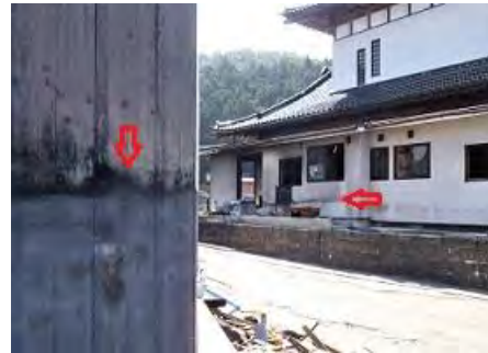
写真16 大浦地区の板壁と建物の外部延焼の焼損痕跡
