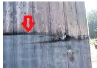
写真18 板壁の焼損線
