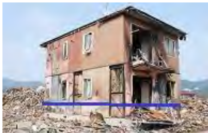
写真14 鹿折地区内の建物の焼損状況
