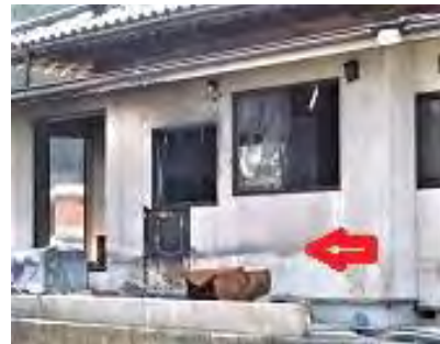
写真17 外周部から内部に延焼した建物
