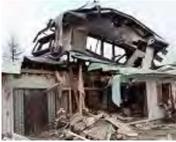
写真10 2階屋の焼損状況、2階のみの焼損
