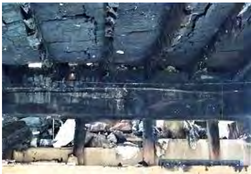
写真11 2階床下の根太と胴差の焼損状況
