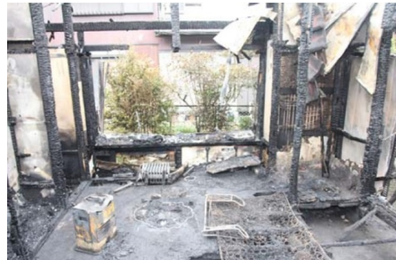
写真 K203-2 発掘後の火災現場の状況
