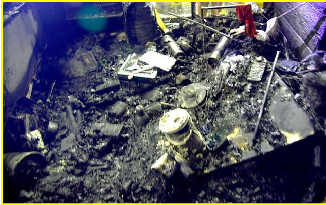
写真 K204-1 鎮火後の火災現場の一室 し、発掘する作業を行う。
