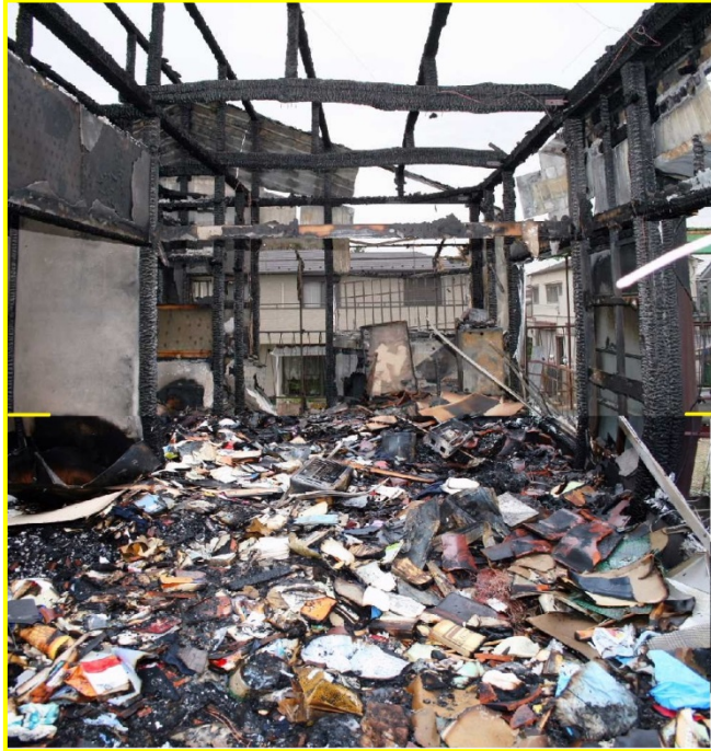
写真 k205-1 全焼火災の焼損状況
