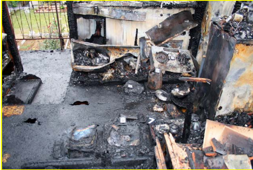
写真 K205-3 火災現場の発掘後の焼損状況
