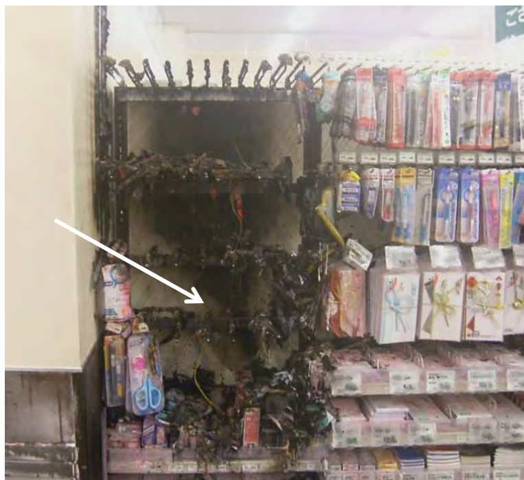
写真 2-1 売り場の焼損状況
