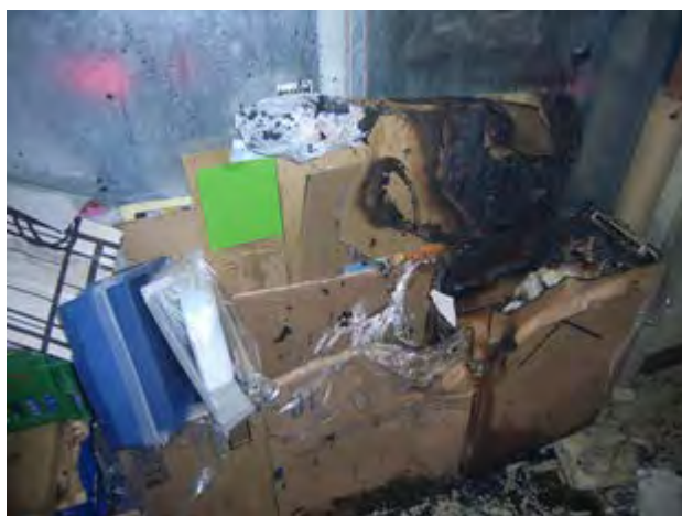
写 3-1 出火したバックヤードの状況
