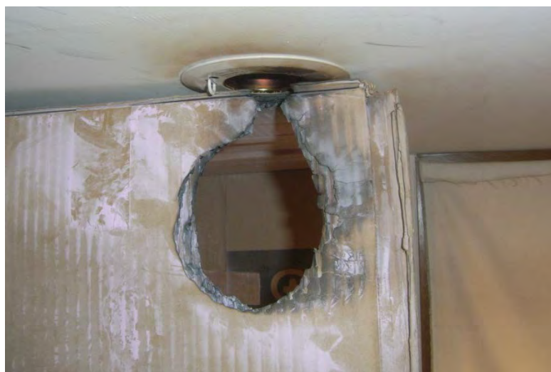
非常灯により近接した段ボールが出火した状況
