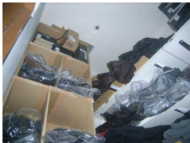
物置の商品の積み上げ。天井のスプリンクラーヘッドの散水障害となっている。
