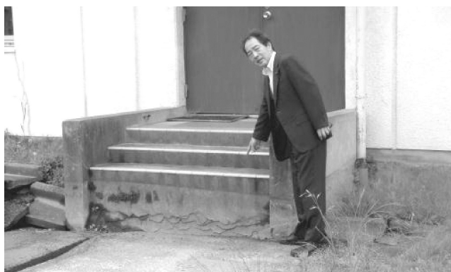
衛生センターの地盤沈下の状況視察 (三反田：6月13日)
