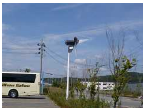
館の前には風力発電設備が設置さ れている
