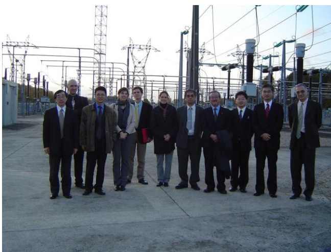
モルブラ変電所見学
