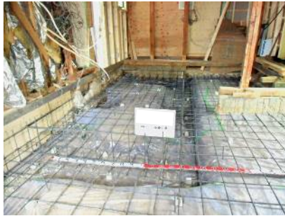
↑ベタ基礎を増設。 耐震強度を高め、地震に強い家になります。また、防湿防蟻の効果もあり、家の寿命を伸ばします。
