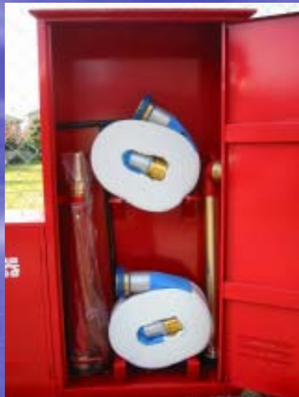
消火ホース・筒先・ハンドル
