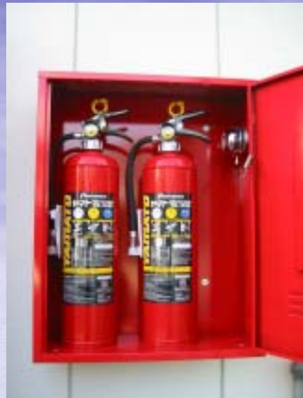
消火器2本ブザーつき
