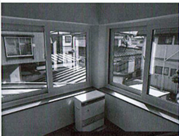
改修後の2階和室 (Low-Eガラス入り、PVCサッシの採用に変更)。
